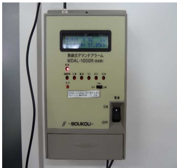
写真1 電力デマンド監視装置
