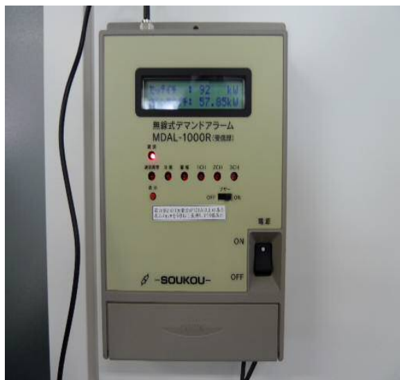
写真1 電力デマンド監視装置
