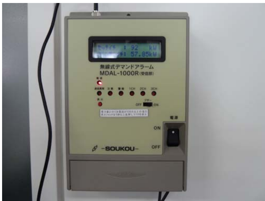
写真1 電力デマンド監視装置
